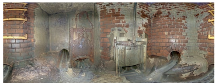
360° Scan inkl. HDR Farbaufnahmen, aufgenommen mit 3D-Laser-scanner Z+F IMAGER 5016. Jedes Pixel hat eine XYZ Koordinate mit mm-Genauigkeit.
