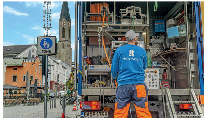
Reinigung, Inspektion und dreidimensionale Erfassung der Leitungsverläufe mit dem professionellen TV-Inspektionsfahrzeug der Fa. Pfaffinger Rohrnetz- & Sanierungstechnik GmbH
